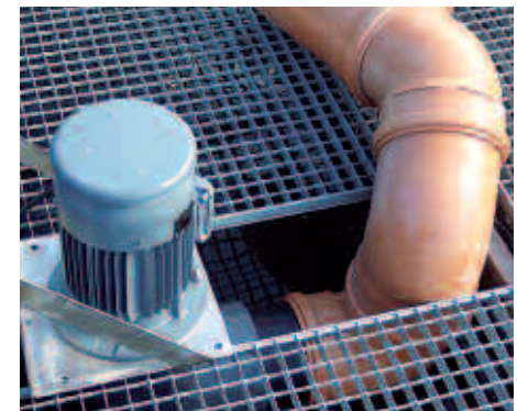
Pumpe Typ 05 in Betrieb montiert
